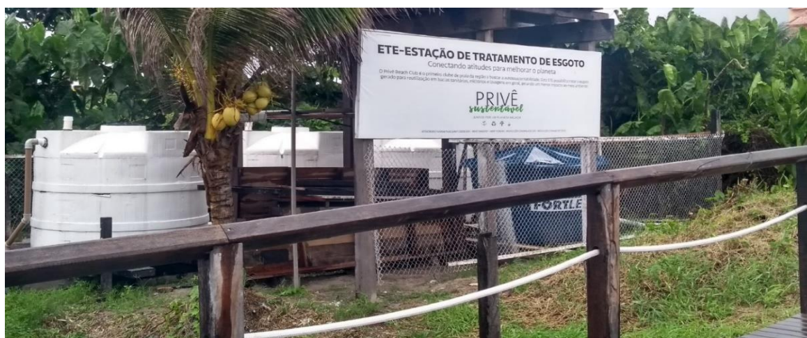
Figura 4 – Estação de tratamento de esgoto de uma barraca na praia do Atalaia, Salinópolis, Pará. Fonte: Autores (2019).
